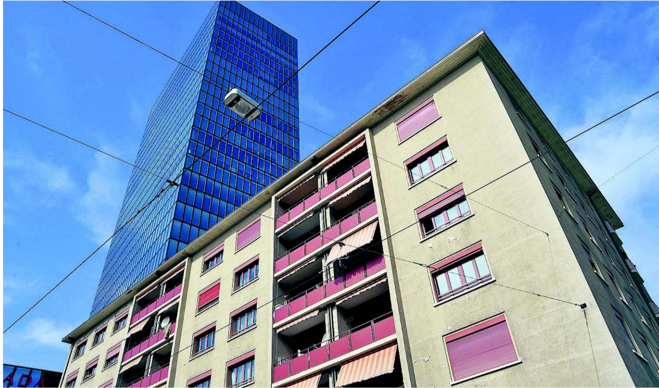
Von der Fassade der Rosenthalhäuser blättert bereits die Farbe ab. Die Zürich Versicherung als Eigentümerin scheint nicht mehr allzu viel in die Bausubstanz zu investieren. MARTIN TÖNGI
